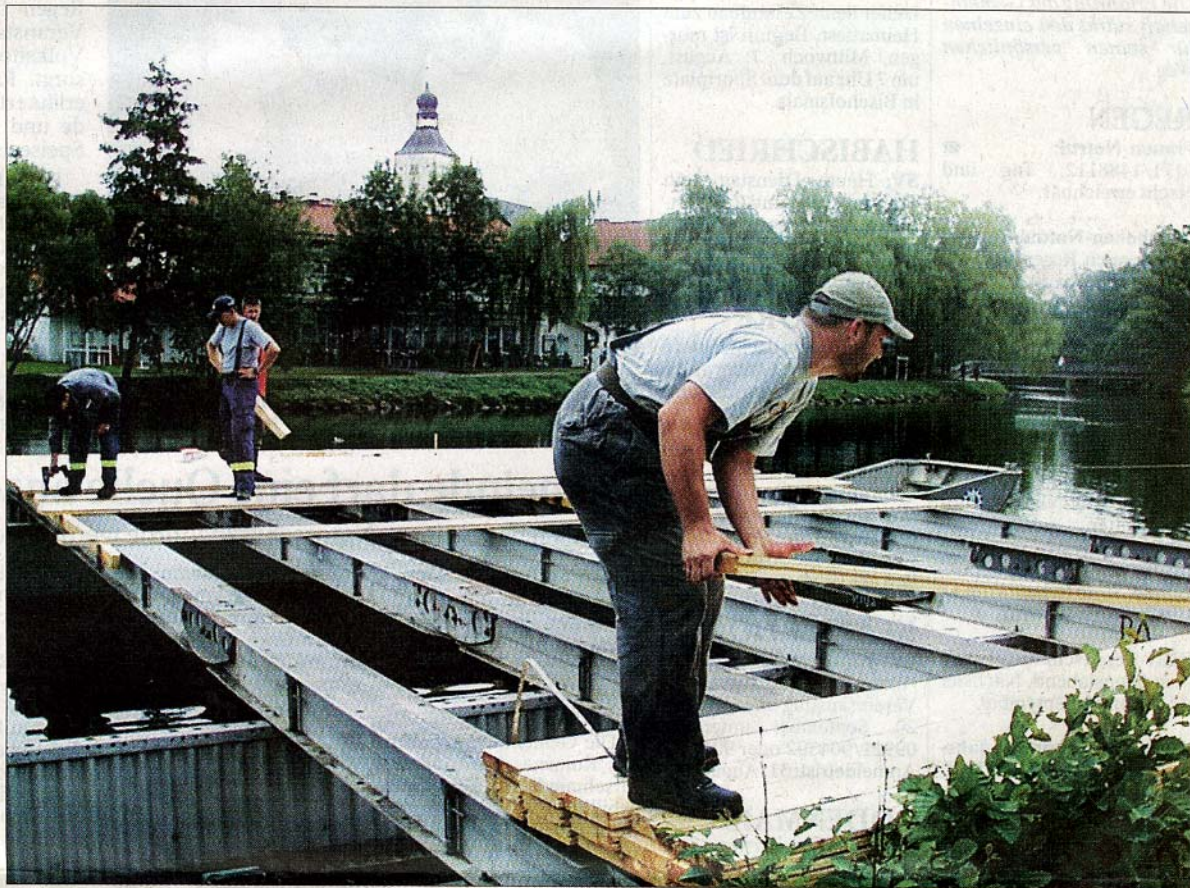
Buckeln für die Kultur: Die Männer des Technischen Hilfswerks bauten am Wochenende in Regen die „Bühne im Fluss“ auf, auf der ab Freitag musiziert und getanzt wird. In dieser Richtung werden auch die Zuschauer auf die Bühne schauen. (F.: Lukaschik)
